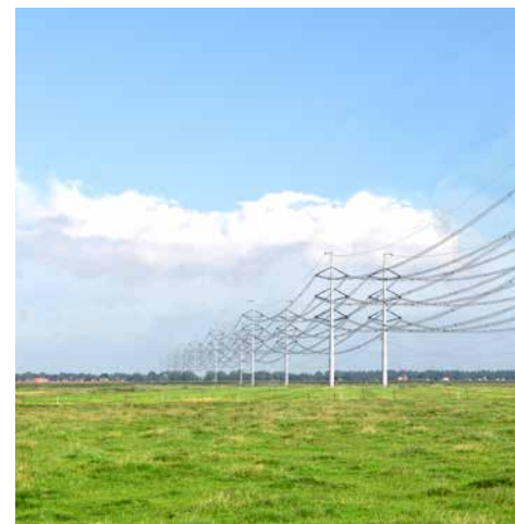
Wintrackmast met vier circuits met vier 380 kV-verbindingen.
