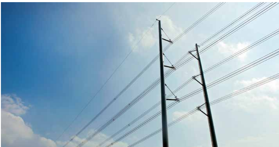
Standaard wintrackmast met twee 380 kV-verbindingen.
